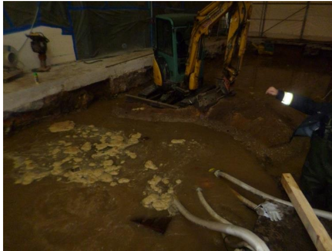
Baugrube unter Wasser.
